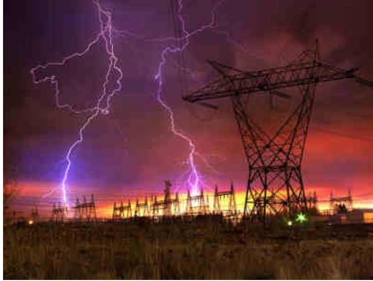
Resim 3- Yüksek gerilim elektrik şalt tesisine yıldırım düşmesi
