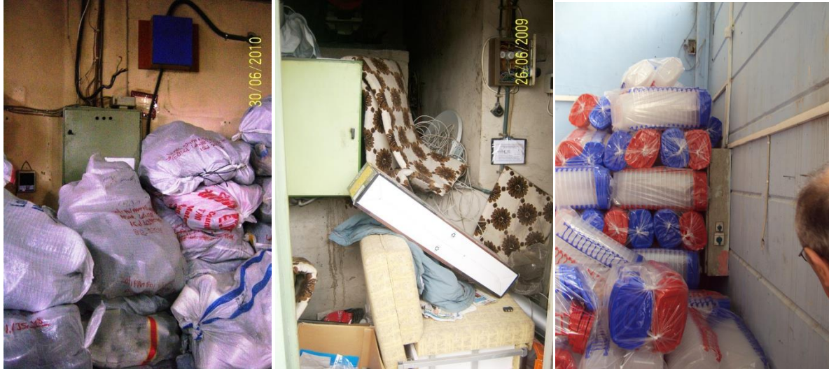
Resim 26-27-28 Pano yakınında yanıcı malzeme bulundurulması
