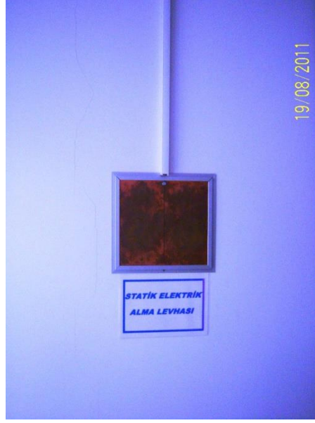
Resim 21- Statik elektrik nötrleme barası
